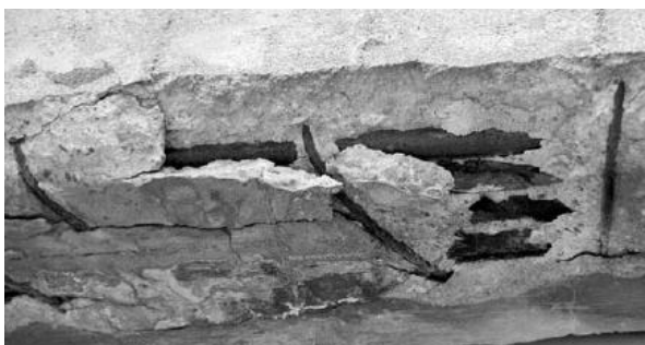
Figur 2.4: Afskallet beton pga. kulsyre og kloridioner, [Hunkeler et al., 2005]
