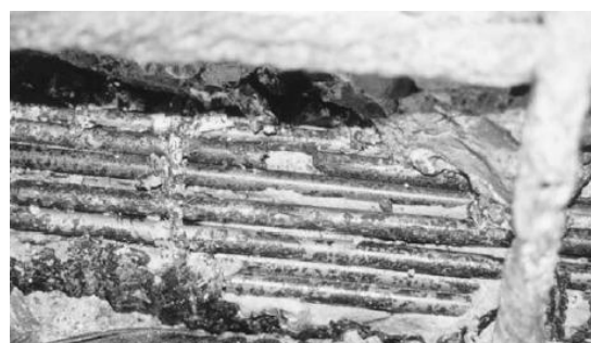
Figur 2.5: Korroderet armering pga. kloridioner, [Hunkeler et al., 2005].
