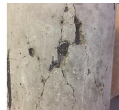
Billed 5: Brud gennem urenheder. I dette tilfælde en asfaltklump.
